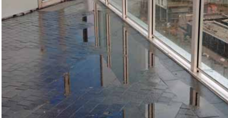
De mange hundrede meter flisebelagte gange er meget ujævne og faldet er forkert, så der samler sig pytter.
