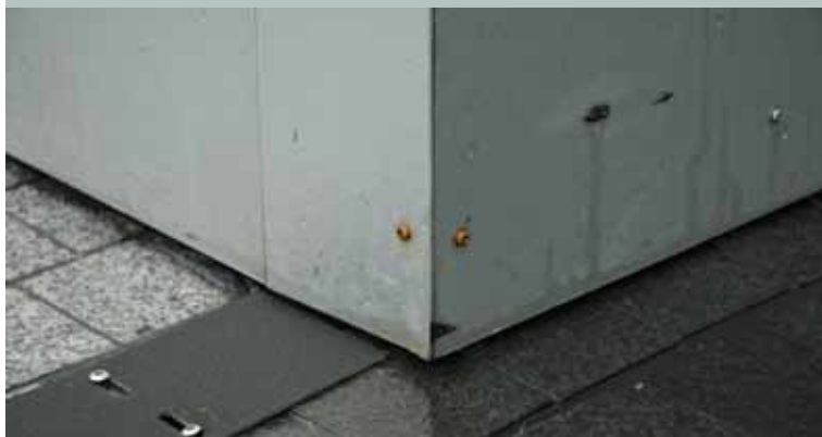
Formentlig galvaniserede skruer i aluminium - det betyder rust.
