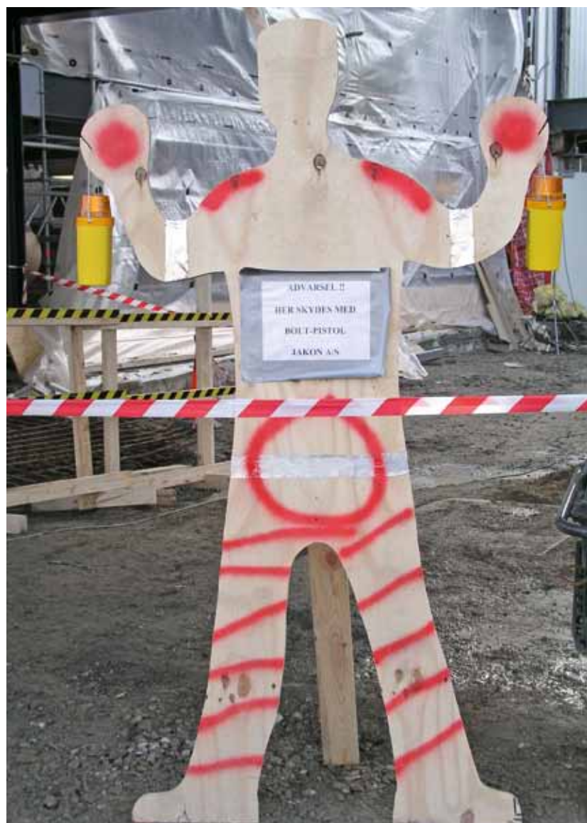
Tydelig afgrænsning af byggepladsen med f.eks. skiltning er en af de nye regler, som Arbejdstilsynet vil håndhæve fra januar i år.
